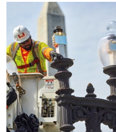
美国 - Equans正在在华盛顿特区进行一宗该国最大的公共照明网络之现代化工程。改用LED和数字控制可减少高达50%的能源消耗。
