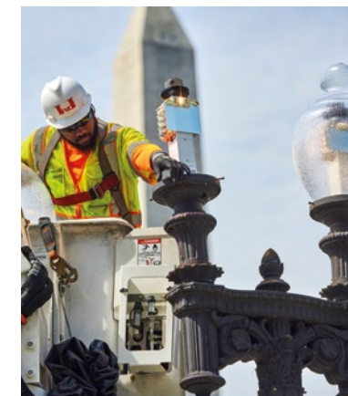
アメリカ - ワシントンD.C.の公衆街路灯 (エクアンスが手掛けた大規模近代化プロジェクトにより、LED照明とデジタル操作への転換が実現して電力消費が最大50%低下)
