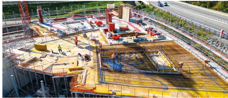
スイス - ベルン・シュタウファッハー通り「BERN131」ビル (ブイグ・コンストラクションの子会社 Losinger Marazzi 社がハイブリッド木材を使って建設)
