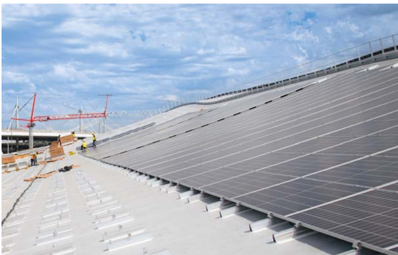
↓ 4 680 m 2 de panneaux photovoltaïques assureront 25 % de la consommation totale d'électricité de l'enceinte.
